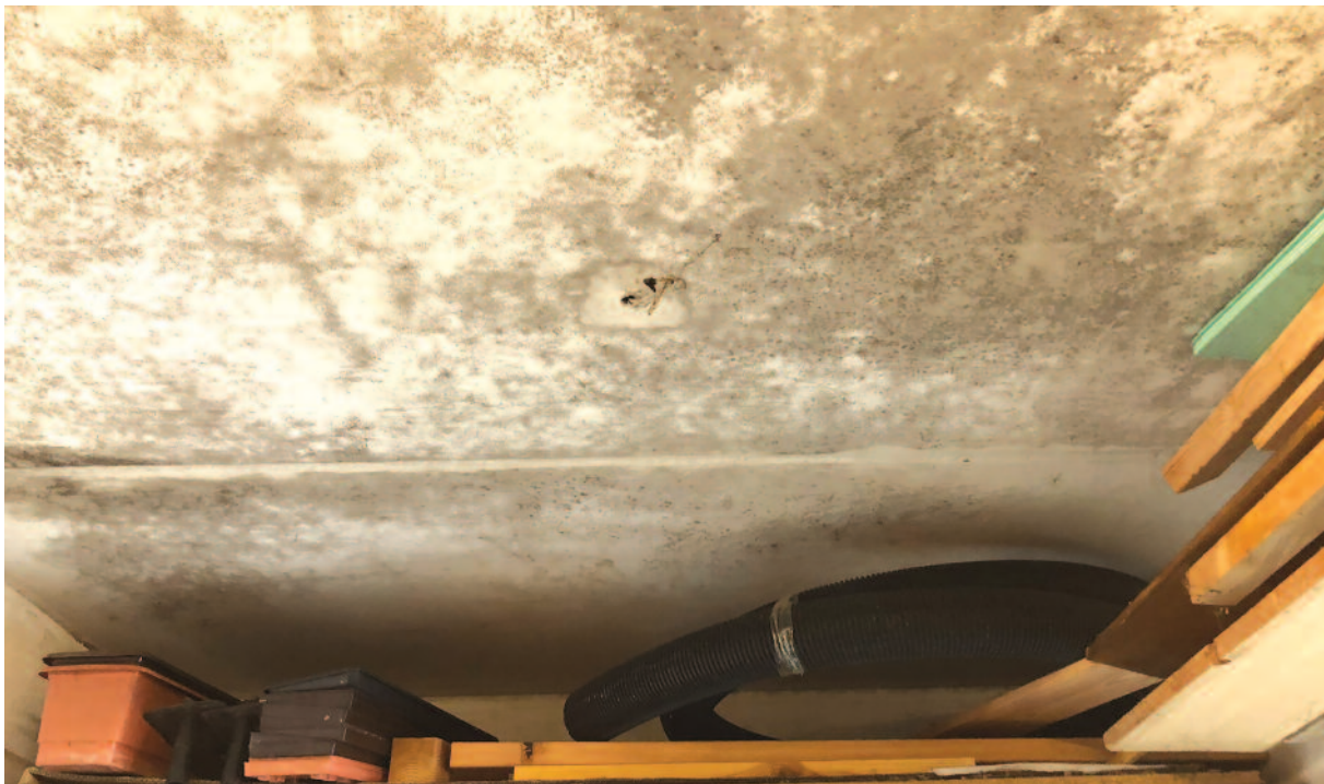
Der Schimmel in Garagen hinter dem Rolltor wurde mit Climate Shield beseitigt.
