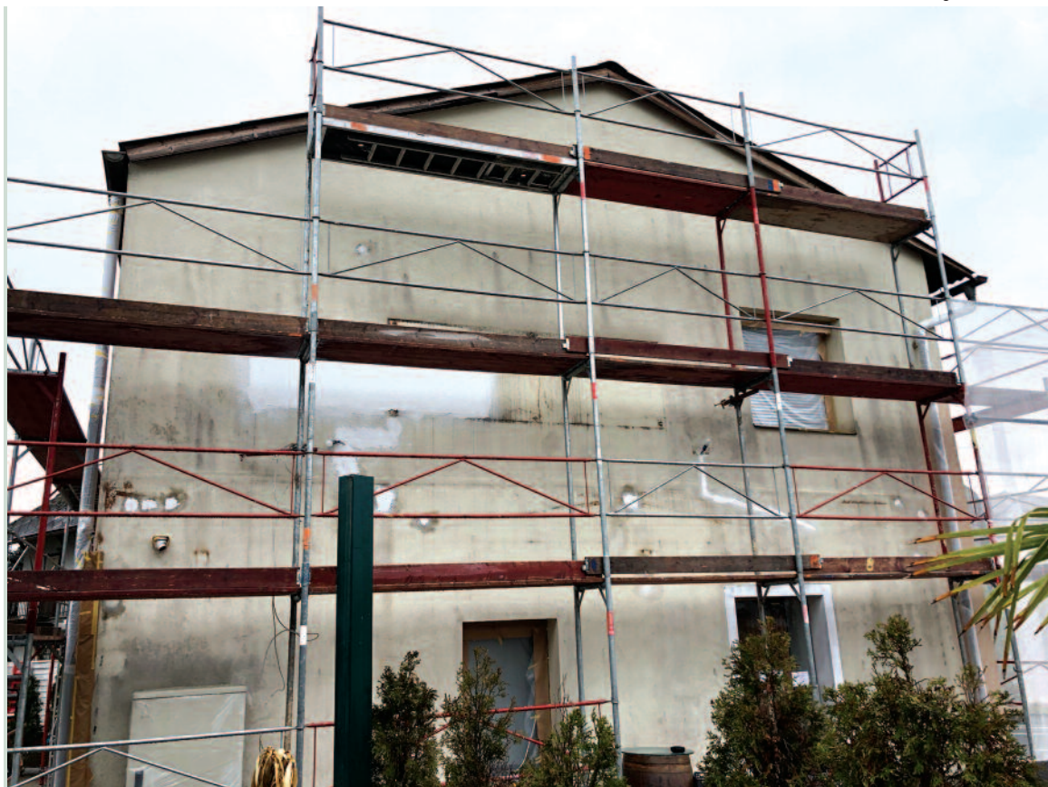
„Typische Wand mit Algenbefall“.
